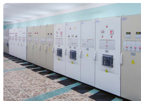
Распределительные устройства КРУ-0,4к в Бакинском метрополитене
