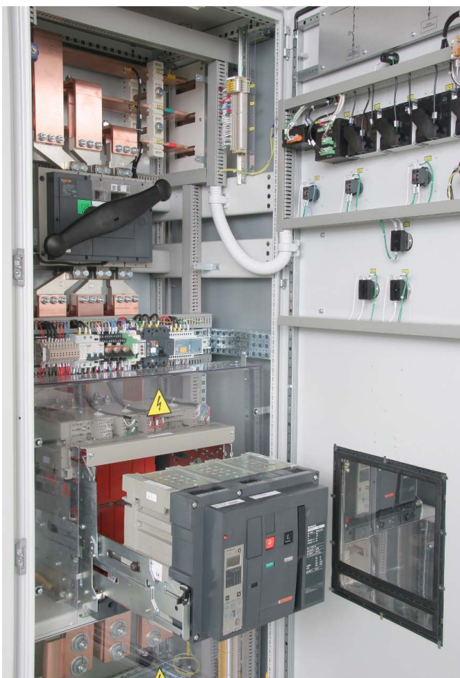
Распределительное устройство KPU-0,4к вводное с выкаченным автоматическим выключателем
