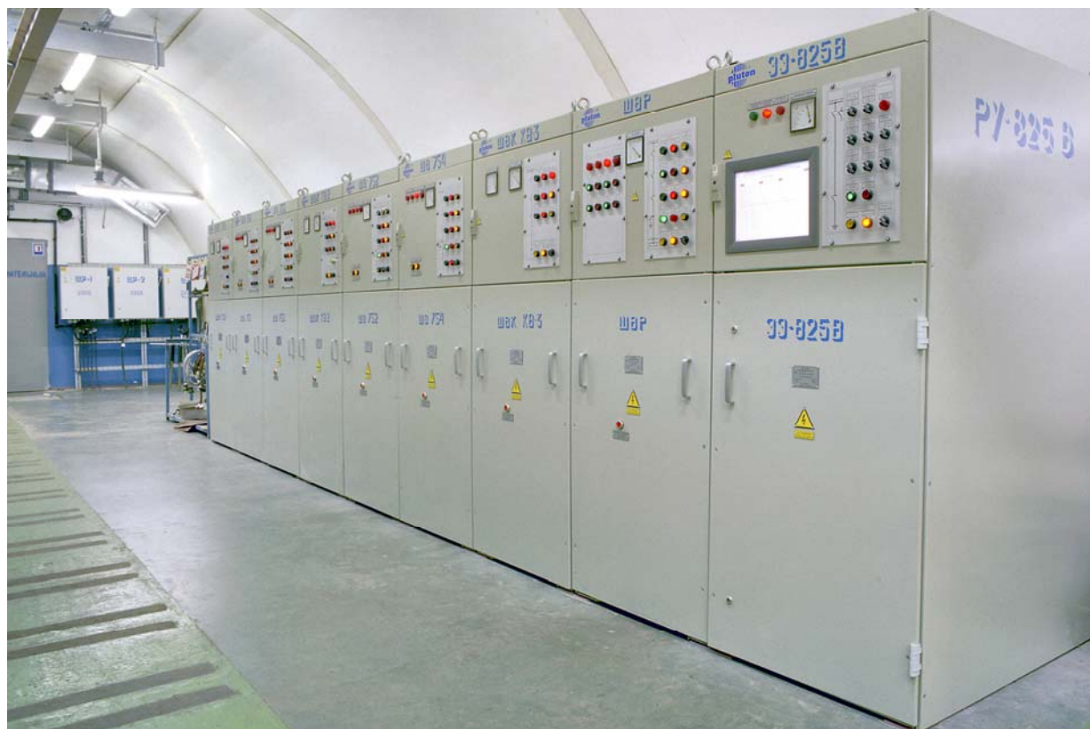
Линейка распределительных устройств серии РУ-825 в Киевском метрополитене
