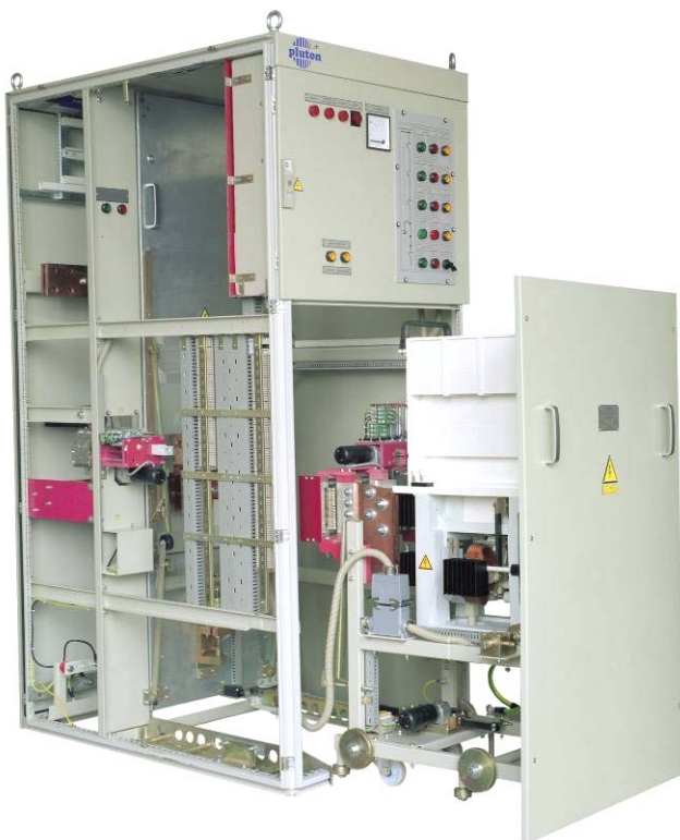
Ячейка РУ-825, выкатная тележка в ремонтном положении
