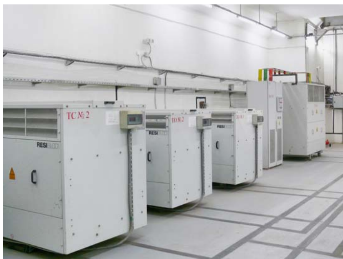
Трансформаторы RESIBLOC® на тяговой подстанции «Райымбек Батыр» Алматинского метрополитена
