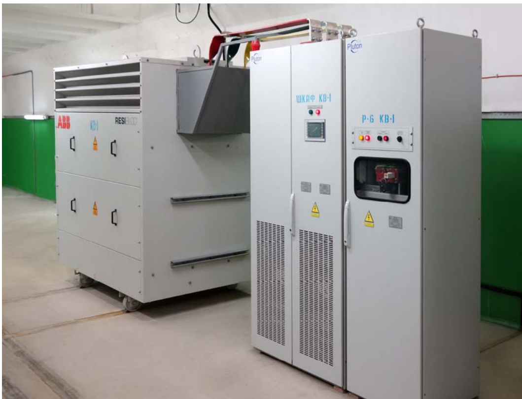
Выпрямитель серии В-ТПЕД, в составе: преобразовательная секция В-ТПЕД (справа) и трансформатор RESIBLOC® (слева)
